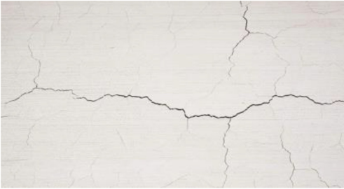
图 2 试验段渠道边坡混凝土裂缝示意图
