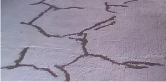
图 1 试验段渠道底板混凝土裂缝示意图
