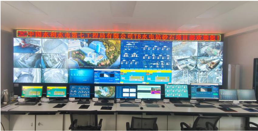
图 2 中控室设备监控系统照片
