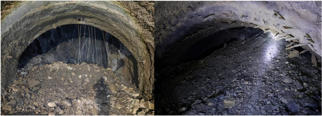
图 1 前期进厂交通洞和通风兼安全洞掌子面塌方及小导管处理效果示意图
