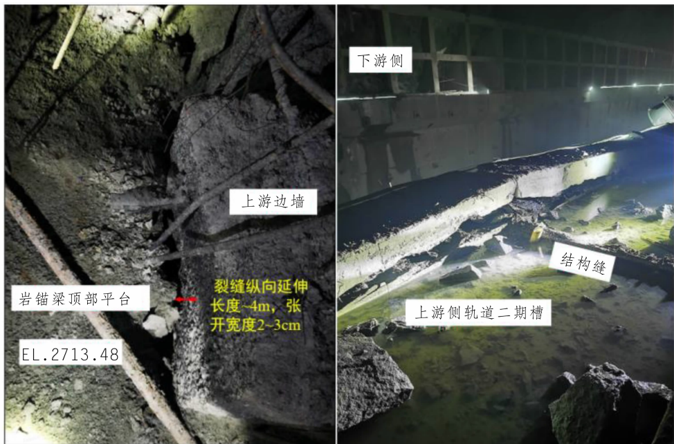
(a)岩壁吊车梁与岩壁脱开
