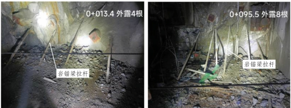
图1 岩壁吊车梁拉杆直接外露
