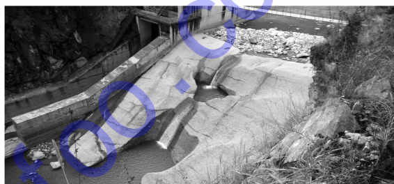
图1 溢流坝损毁状况示意图
