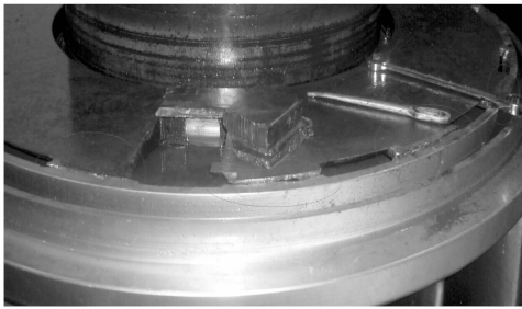
图2 2号机组泵板开裂、配重块脱落示意图
