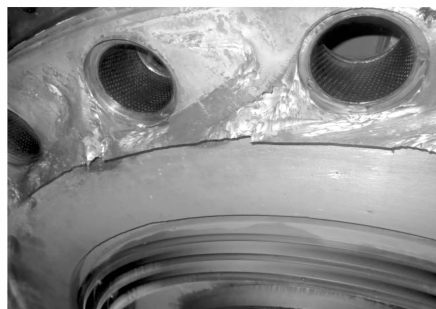
图2 顶盖磨损气蚀情况
