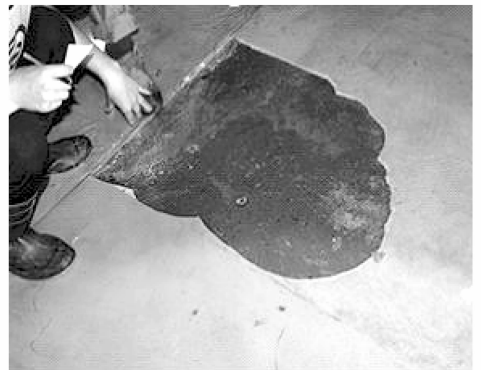
图 2 冲沙放空洞底板环氧砂浆保护层冲蚀
