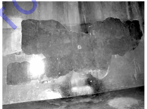
图 1 泄洪洞边墙环氧砂浆保护层冲蚀
