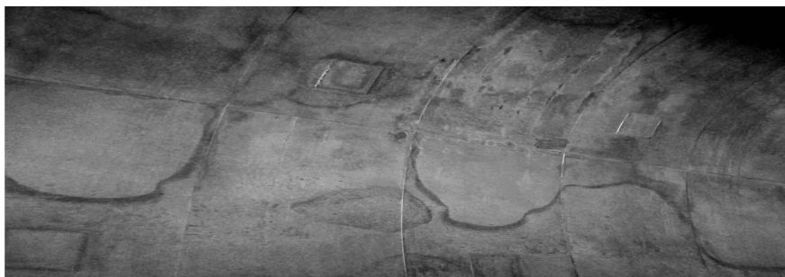
图2 混凝土层间不均匀形成的混凝土表面色差图
