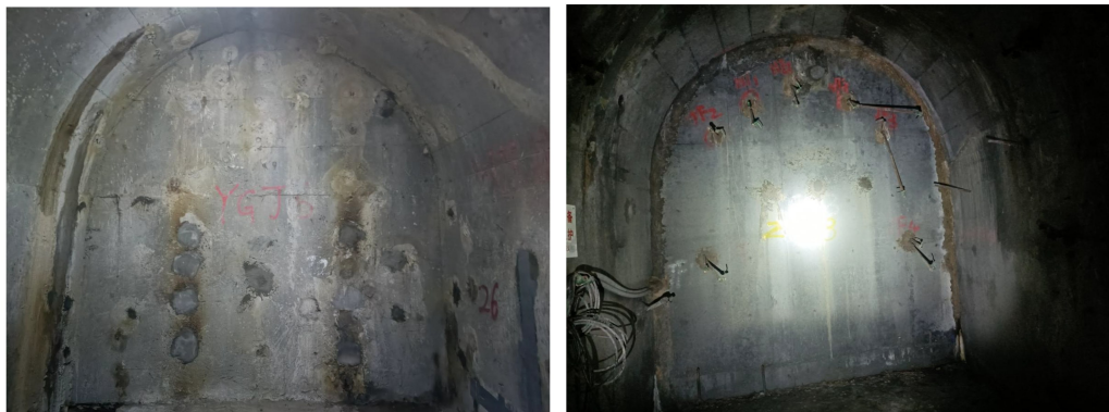
图 3 260 m 水头压力条件下洞口及端头部位的整体干燥、无明显渗漏水情况
