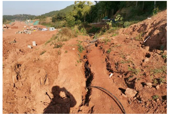
图3 放坡平台变形裂缝
