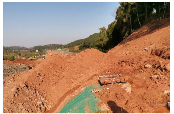
图4 二级放坡平台失稳破坏
