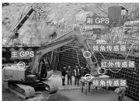
图 5 现场施工监控系统硬件安装图
