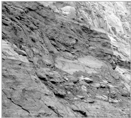
图 5 红层边坡开挖后快速风化、崩落
