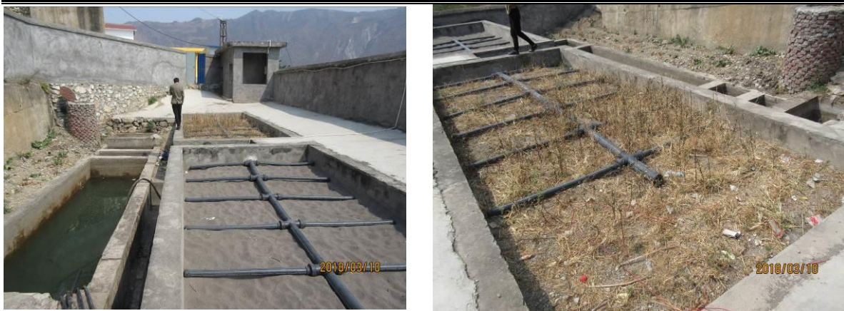
头水区污水处理站
