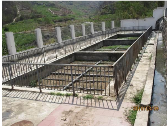
图 3.1.1-5 卡哈洛乡集镇污水处理站现状
