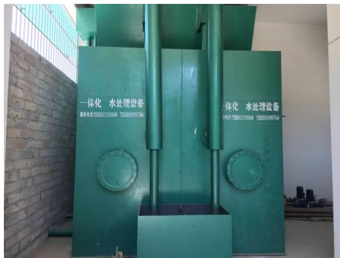
图 3.1.2-4 务基青龙安置点污水处理站
