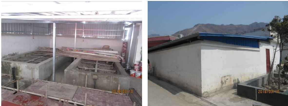
坳田区污水处理站
