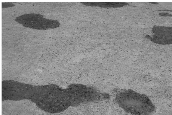
图 2 消力池底板表面磨损情况
