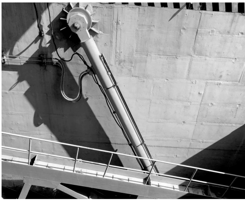
图4 在油缸上安装 CWY-CB1-4500-1S1-411-10 型静磁栅闸门行程传感器照片
