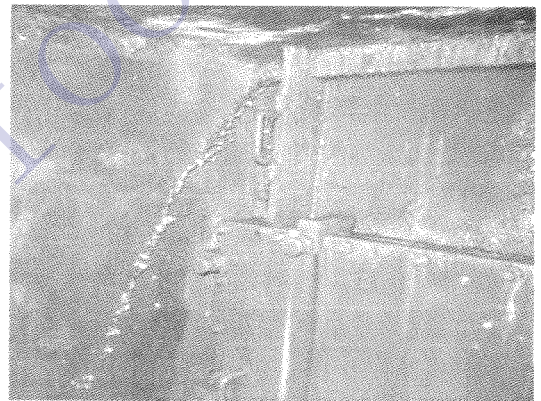
图1 尾水管进入门钢衬漏水情况
