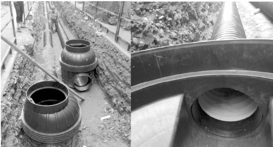
图 4 管道与塑料检查井的连接照片
