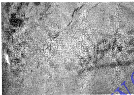
图1 厂房下游拱座厂横0+120~0+135桩号段围岩片帮引起的混凝土喷层开裂图
