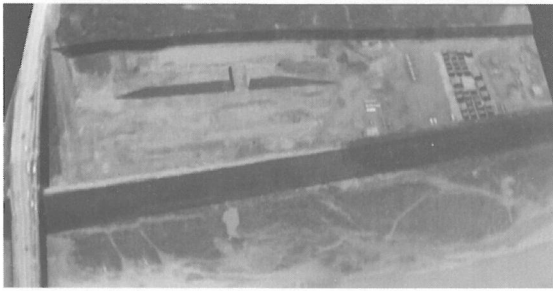
图5 堤坝损毁正摄投影图(都江堰架青桥)
