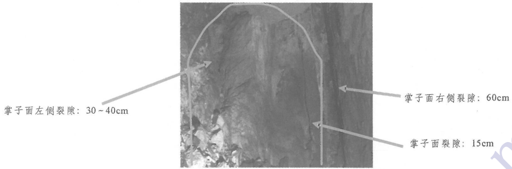
图2 泥夹石裂缝图
